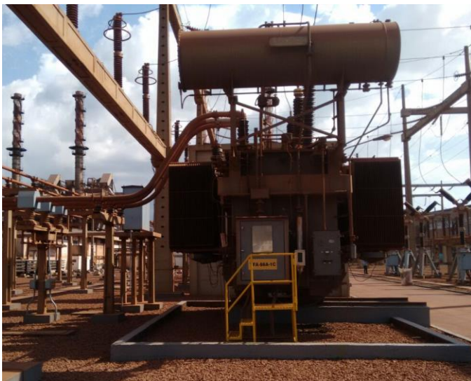
Figura 1 Transformador de potência 50/70 MVA Fonte: [autores].
