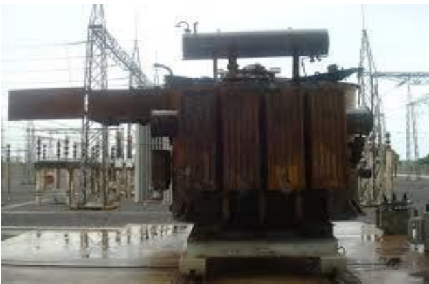
Figura3. Transformador queimado. Fonte: [autores].
